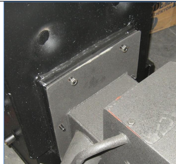
Малюнок 31. Встановлений на котлі корпус шнекової подачі.
